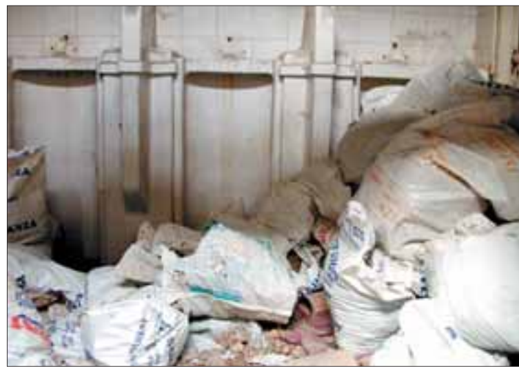
BAÑOS INUTILIZABLES. Imagen mostrada durante la comisión de Urbanismo de ayer de los baños del Euskal Jai. Los aseos se encuentran inutilizables y han sido empleados para almacenar escombros.
